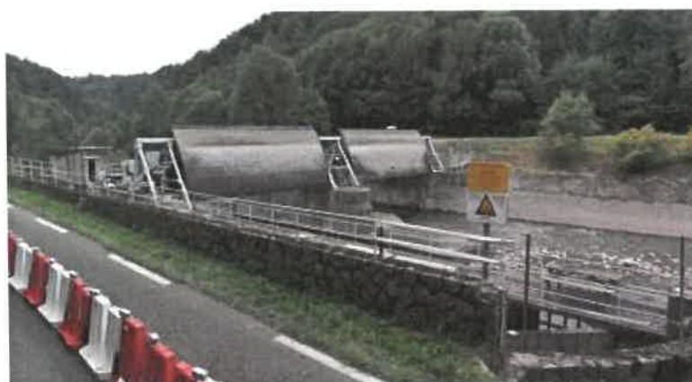
Figure 577 : barrage de Quercabanac sur le Salat à Soueix-Rogalle avec ses 2 vannes secteurs visibles
