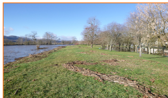
Digue de Bonrepaux partiellement submergée par la crue du 10 janvier 2022
