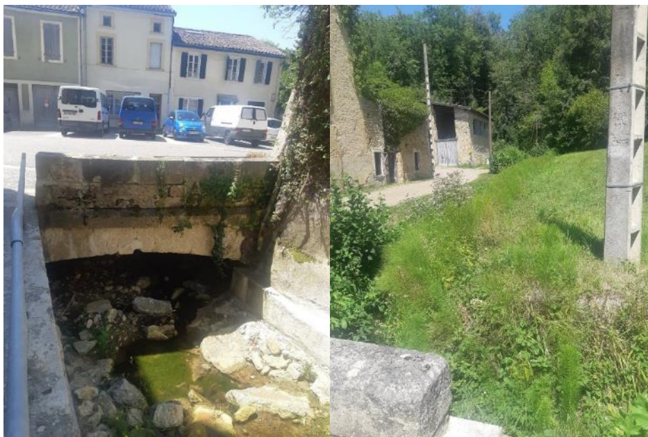
Figure 53 : pont de la RD35 à Sainte-Croix-Volvestre sur le ruisseau de Saint-Jean (à gauche) et de Vieille (à droite)
